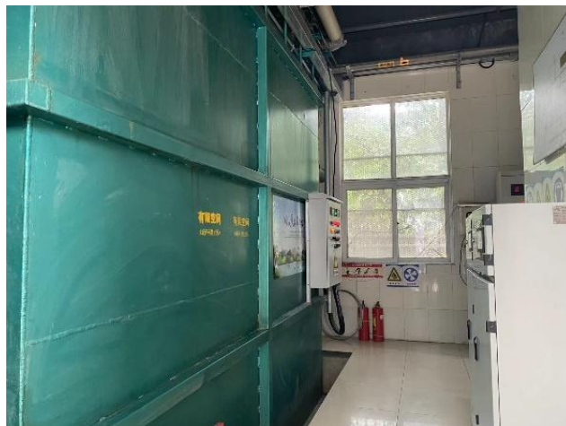
图 3-2 污水处理站污水处理单元现状
